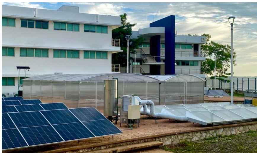
Figura 1. Planta de secado solar.
